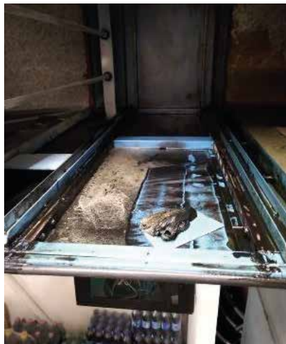
Ilustración 10. Limpieza a la carcasa interna del equipo.
